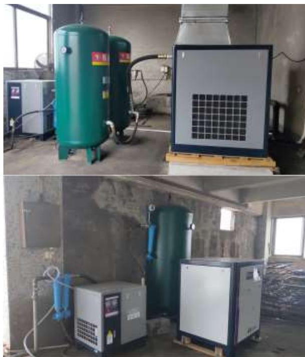
1台22kW和1台55kW 配備永磁電機及變頻功能的節能螺桿空氣壓縮機
